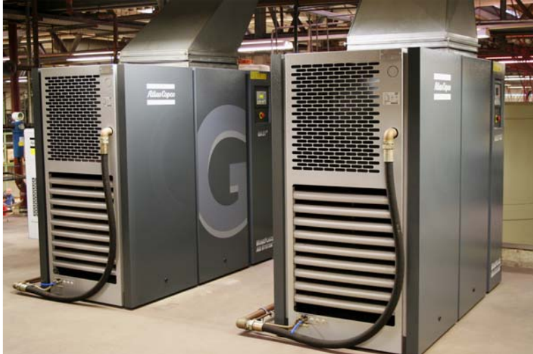
Blick auf die Druckluftstation mit den beiden GA-Schraubenkompressoren und dem Kältetrockner. (Bild: Atlas Copco Kompressoren und Drucklufttechnik GmbH)
